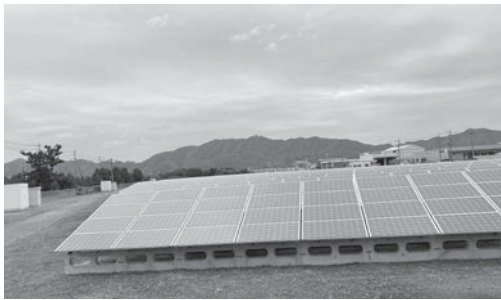
市内に多く見られる太陽光発電設備 (竹内工業団地)
