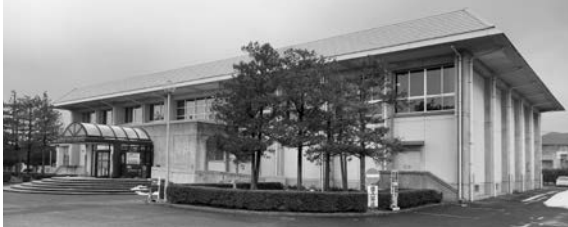
外壁改修を必要としている第2市民体育館
