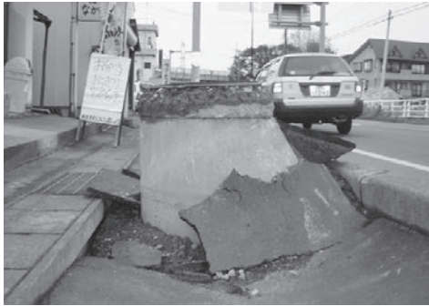
地震災害時の下水管の状況 【出展：日本下水道管路管理業協会】
