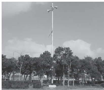
防災行政無線の屋外スピーカー
